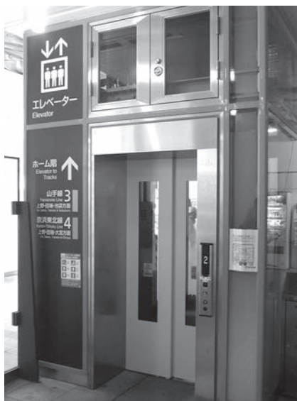
JR御徒町駅南口エレベーター
